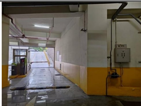
大雨過後地下停車場經常漏水
