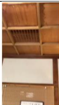
館舍室內漏水問題
