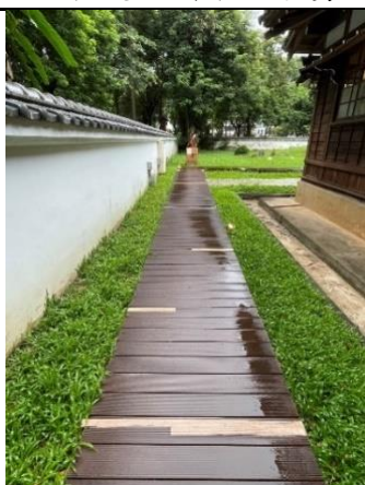
庭院木棧道多處破損
