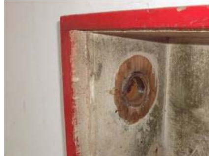
消防用水接管口
