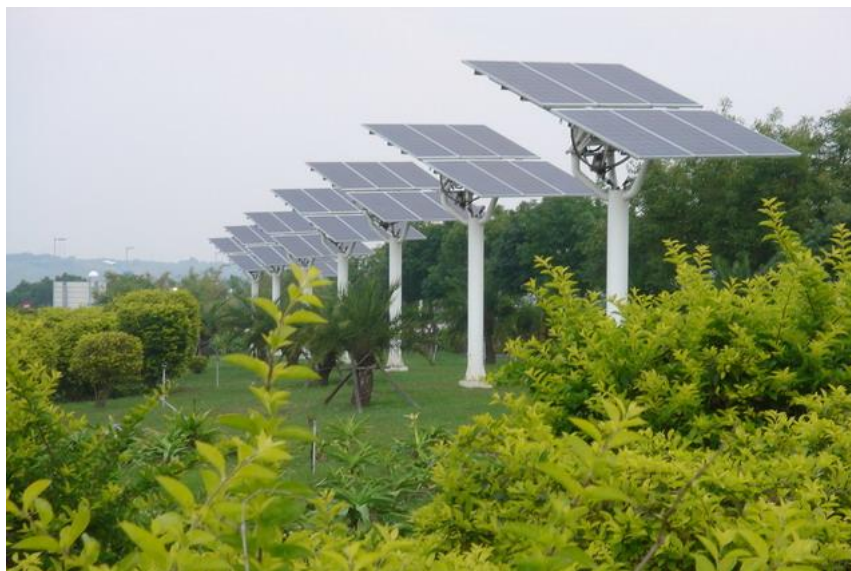
照片7-7 太陽能發電
