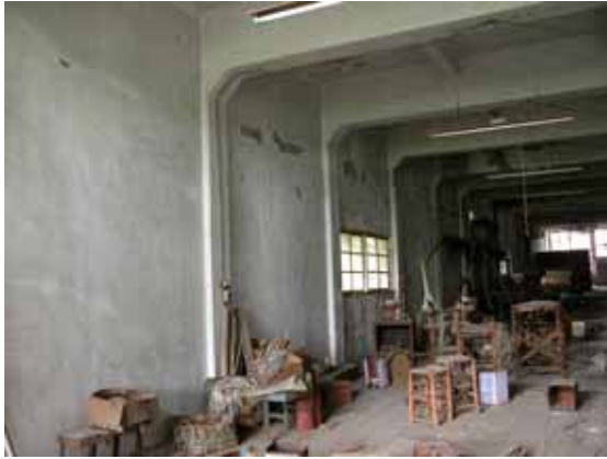
相 2-1 乾燥庫房牆體裂縫照片
