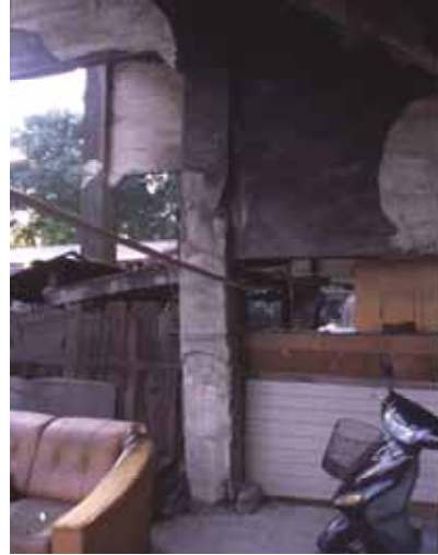
相 2-23 柱身破壞狀況
