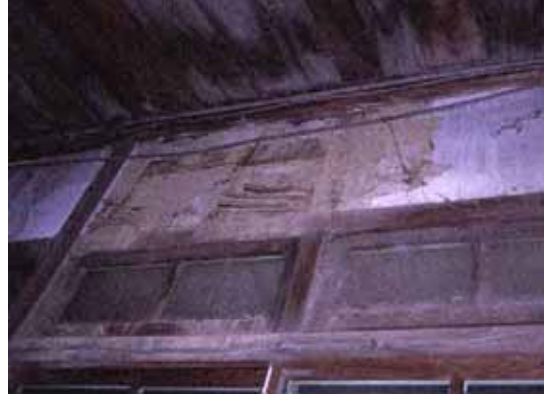
相 2-36 窗框上緣牆體破壞
