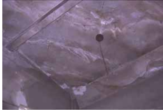
相 2-10 屋頂角落有裂縫發生且滲水嚴重
