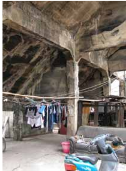
相 2-17 柱身破壞狀況
