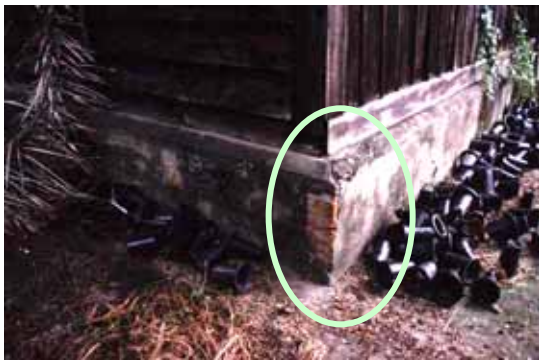
相 2-67 磚基礎轉角破損
