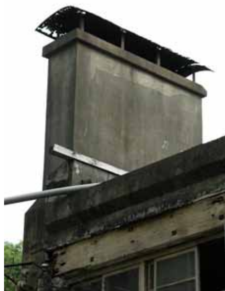
相2-5 乾燥庫房煙囪保護蓋破損與窗楣腐朽狀況
