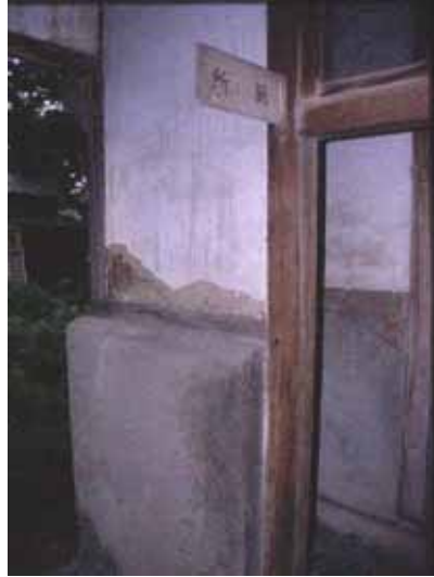
相 2-41 編竹夾泥牆體局部毀損
