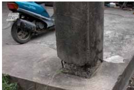
相 2-15 柱腳破壞狀況
