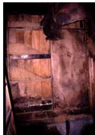
相 2-64 雨淋板內壁板腐朽
