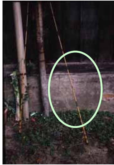
相 2-66 磚基礎上垂直裂縫
