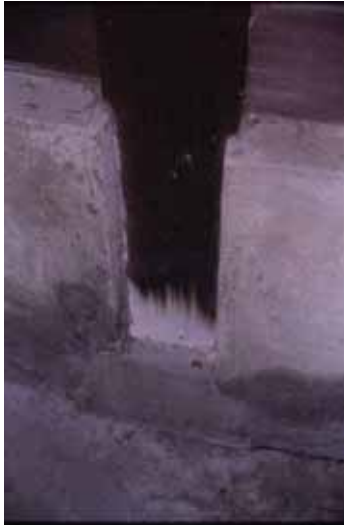
相 2-60 柱材潮濕局部腐朽
