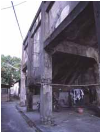
相 2-14 柱身及柱腳破壞狀況
