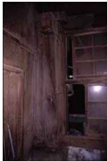
相 2-74 機具工廠 B 區構件腐朽
