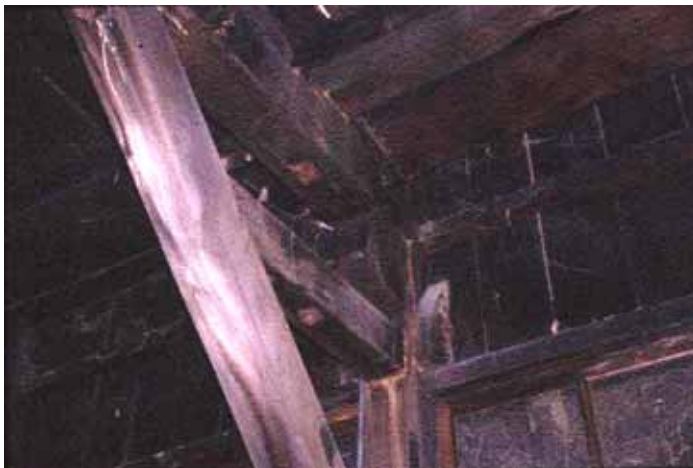
相 2-63 排水管破損導致構件腐朽且有水漬現象
