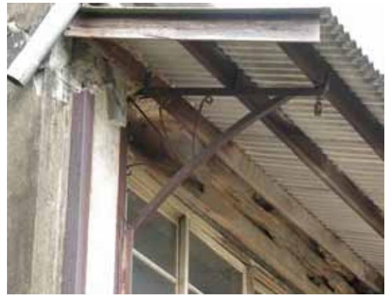
相 2-4 乾燥庫房外飾材破壞窗楣腐朽
