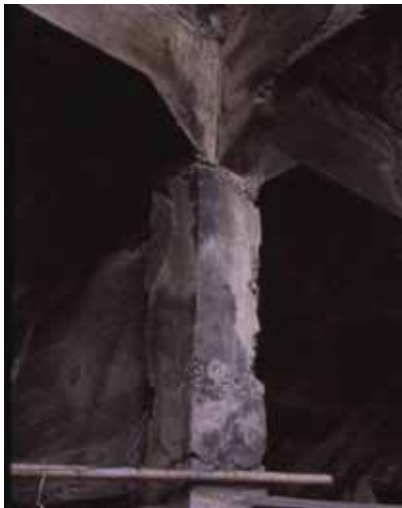
相 2-18 柱頭破壞狀況
