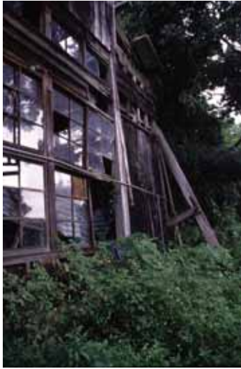
相 2-65 部分窗戶玻璃破損
