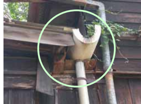
相 2-68 木製排水管腐朽破損
