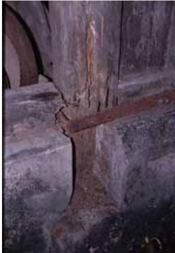
相 2-71 機具工廠北向立面構件腐朽
