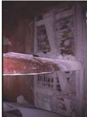
相 2-37 雨淋板牆內部牆體破壞
