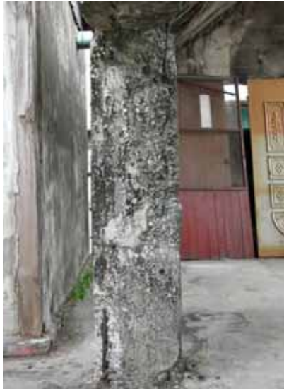
相 2-16 柱腳破壞狀況
