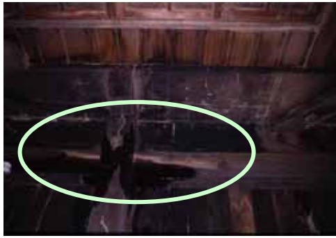
相 2-53 屋頂漏水現象
