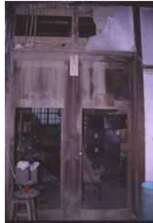
相 2-38 門框上方懸牆破壞
