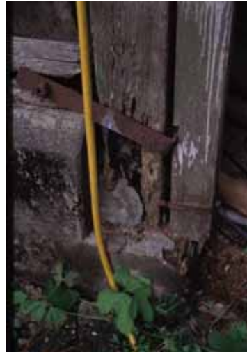
相 2-70 機具工廠北向立面構件腐朽破壞
