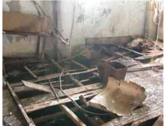
相 2-2 乾燥庫房架高地板腐朽破壞
