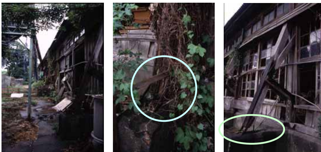
相 2-45 『K 字型斜撐』腐朽 相 2-46 斜撐構件局部腐朽 相 2-47 斜撐構件局部腐
