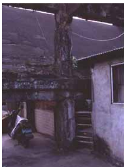
相 2-21 柱頭及柱身破壞狀況
