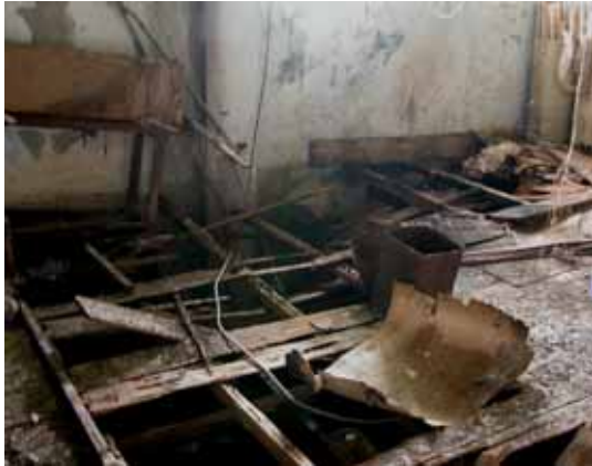
相 2-69 乾燥庫房樓板腐朽塌陷
