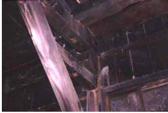
相 2-76 機具工場 C 區構件腐朽且遭白蟻攻擊
