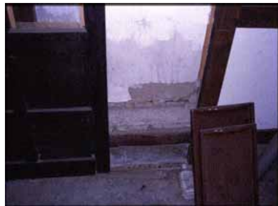
相 2-31 東側雨庇腐朽破壞
