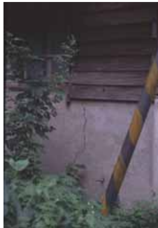
相 2-43 基礎垂直向裂縫
