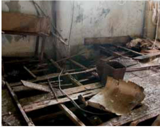
相 2-6 乾燥庫房樓板腐朽塌陷
