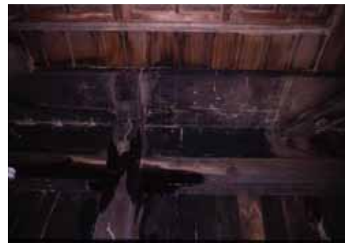
相 2-72 機具工廠 B 區構件腐朽
