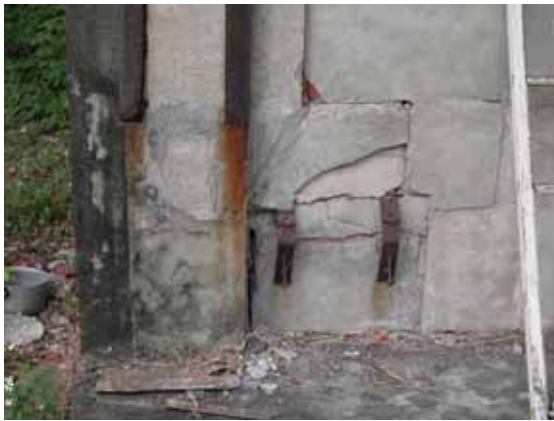
相 2-3 乾燥庫房角落外飾材破壞磚材露出
