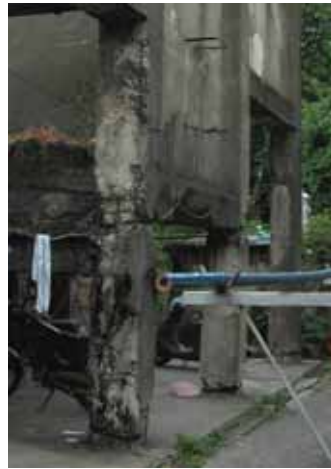
相 2-13 柱身及柱腳破壞狀況
