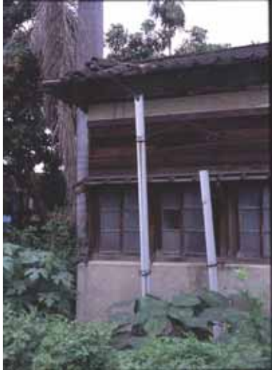
相 2-40 排水溝脫落異位
