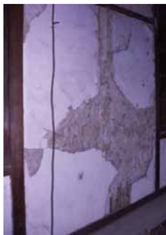
相 2-33 北側編竹夾泥牆破壞
