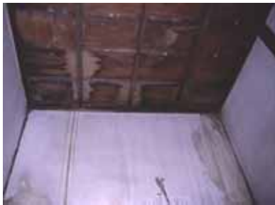
相 2-42 天花板嚴重漏水痕跡
