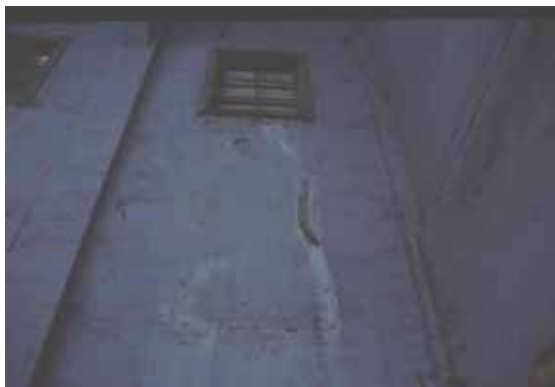
相 2-7 入口上端牆體發現垂直向裂縫的痕跡
