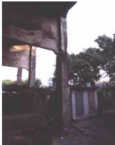
相 2-19 柱身破壞狀況
