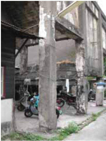
相 2-12 柱身破壞狀況
