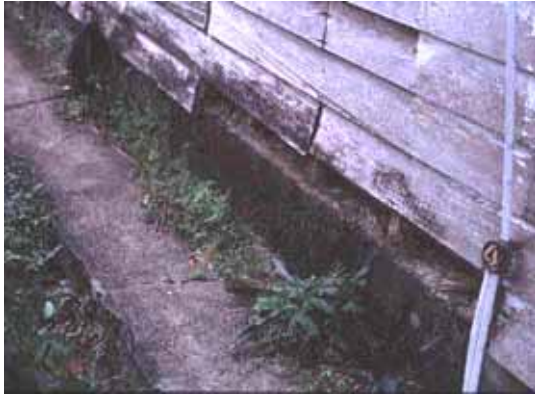
相 2-35 雨淋板與基礎交接處腐朽
