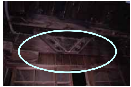
相 2-57 桁架梁水漬現象並有生物性劣化
