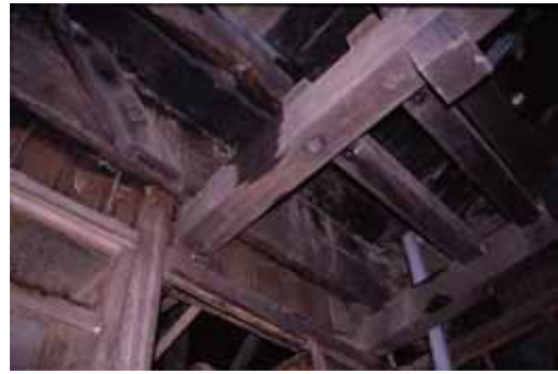
相 2-54 屋頂漏水現象
