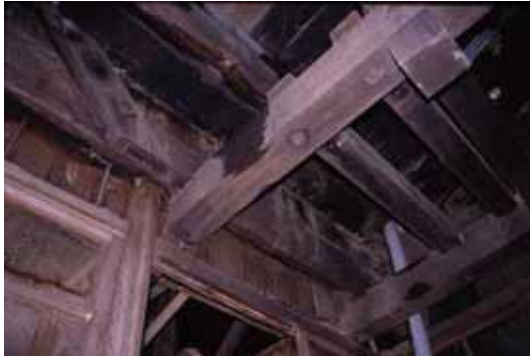
相 2-75 機具工廠 B 區構件腐朽
