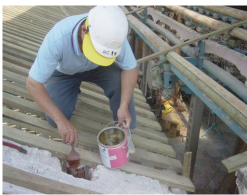
〔照片5-1-4〕木構件入牆部分應加強防腐防潮處理2
