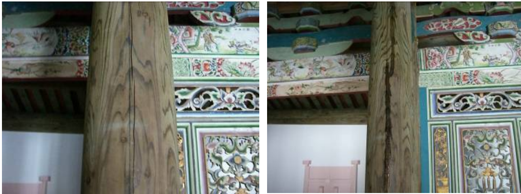
〔照片5-1-15〕抽換木柱之木料自然或人工開裂 〔照片5-1-16〕缺失修補改善完成
