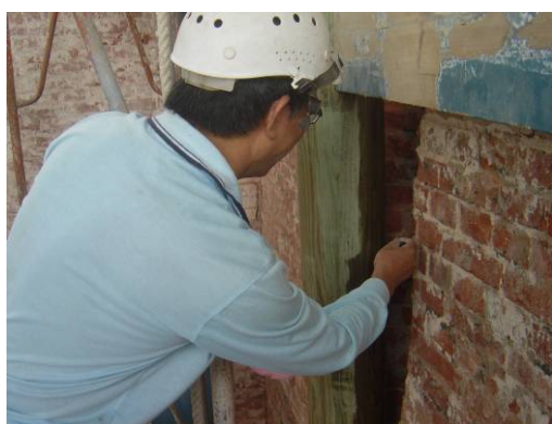
〔照片5-1-3〕木構件入牆部分應加強防腐防潮處理1
