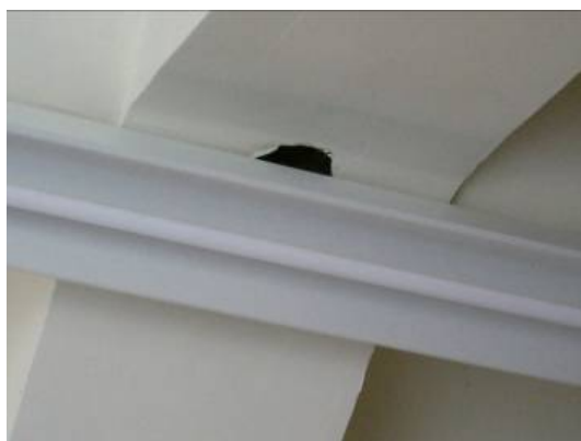
〔照片5-1-11〕廂房燈具線盒露出之缺失
