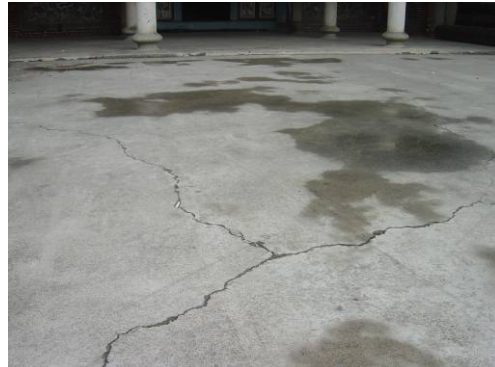
〔照片4-1-71〕原有地坪龜裂2
