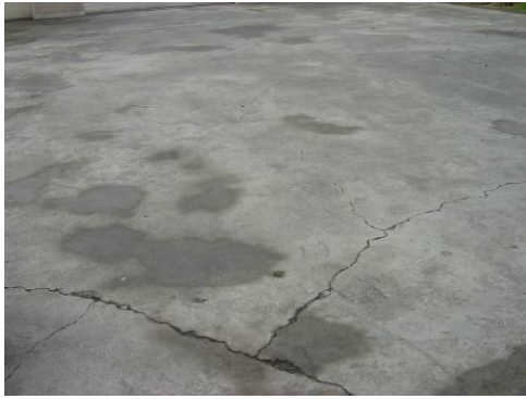
〔照片4-1-70〕原有地坪龜裂1
