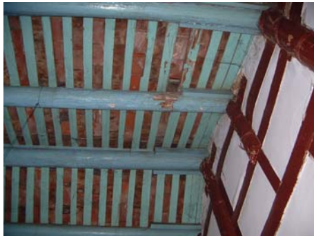
圖 44 屋桁腐朽受損情形
