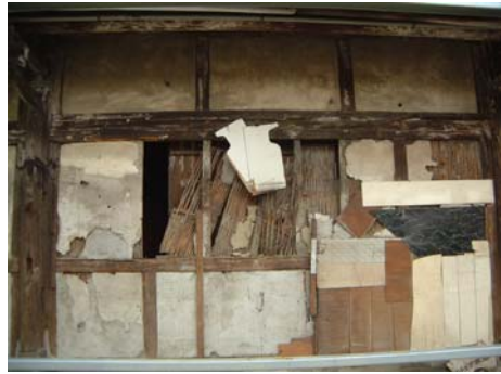
圖 41 編竹夾泥牆構造損毀嚴重
