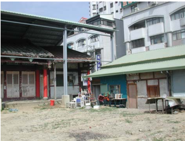
圖 53 屋面破損情形
