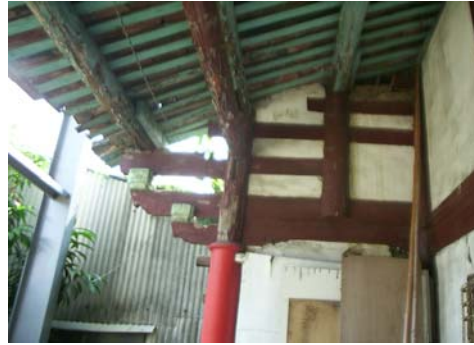
圖 42 簷廊木構件腐朽蛀蝕
