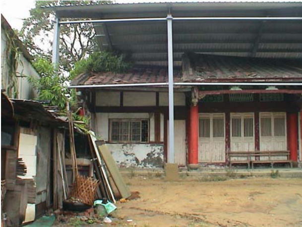
圖 52 屋面破損情形
