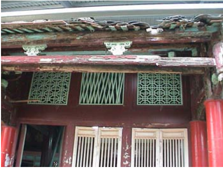
圖 47 窗櫺腐朽受損情形
