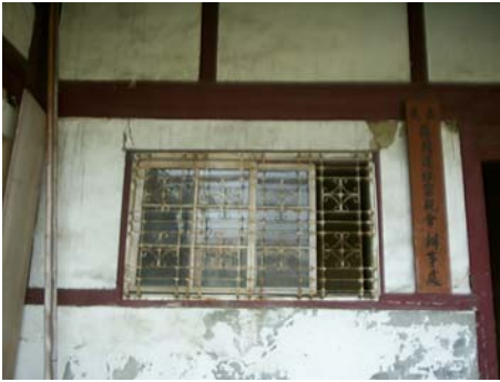
圖 49 門窗腐朽受損情形
