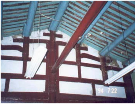
圖 45 屋桁腐朽受損情形
