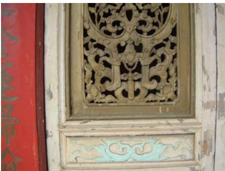
圖 51 門扇腐朽受損情形
