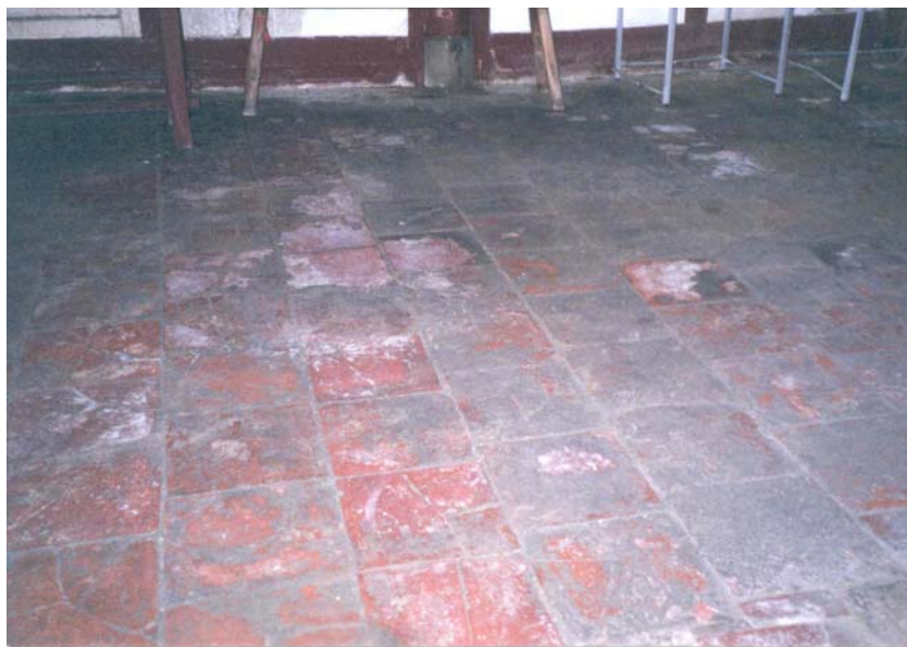
圖 40 室內尺磚地坪
