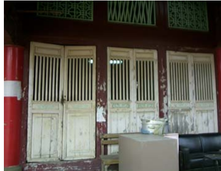
圖 48 門窗腐朽受損情形
