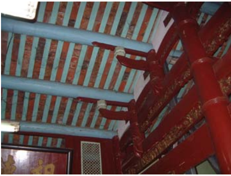
圖 43 神龕上方屋桁腐朽受損情形
