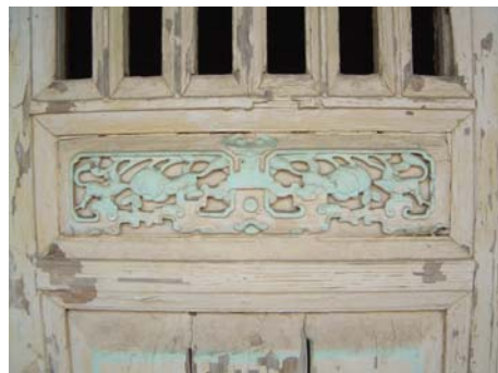
圖 50 門扇腐朽受損情形
