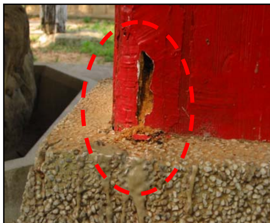
圖 97 手水舍柱基有腐朽現象
