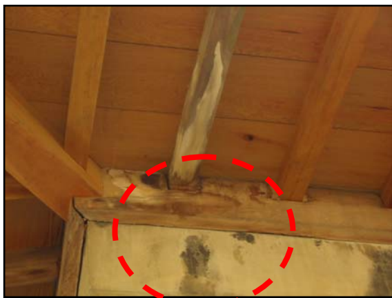
圖 96 祭器庫(神輿庫)室內構件有嚴重水漬
