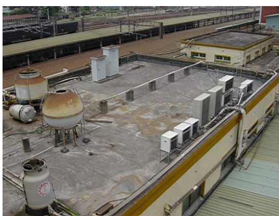
【圖 4-9-6】106R 屋頂各空調設備
