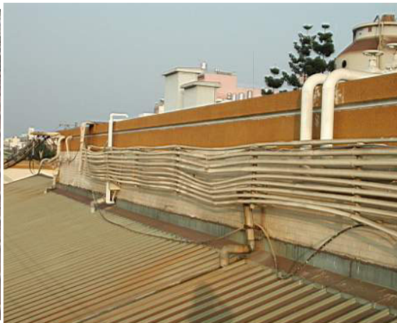
【圖 4-9-14】部分管線固定於女兒牆外側，但因為月台雨棚的遮蔽旅客不易看到
