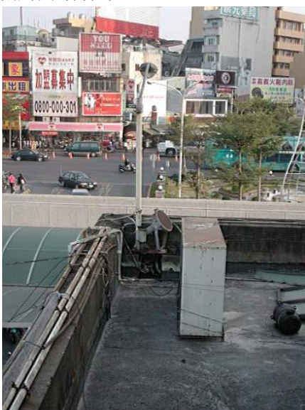
【圖 4-9-15】部分戶外照明燈具與纜線箱固定於有女兒牆的屋頂上
