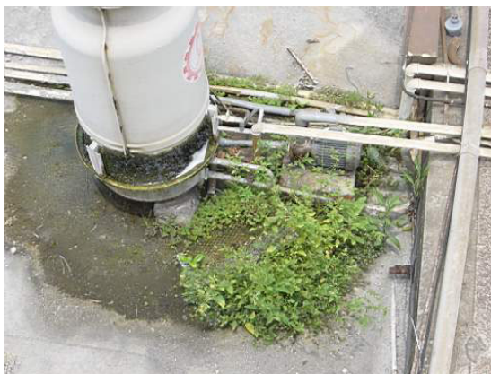
【圖 4-9-4】106R 冷卻水塔附近積水處的植物危害
