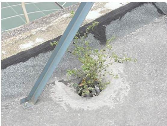
【圖 4-9-3】105R 落水孔處的植物危害
