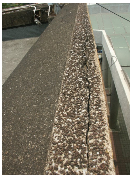
【圖 4-9-16】101R 女兒牆南側開裂
