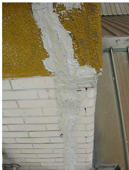
【圖 4-9-18】101R 西南側女兒牆開裂和修補
