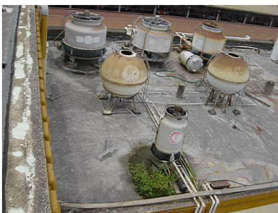
【圖 4-9-5】106R 屋頂各空調設備
