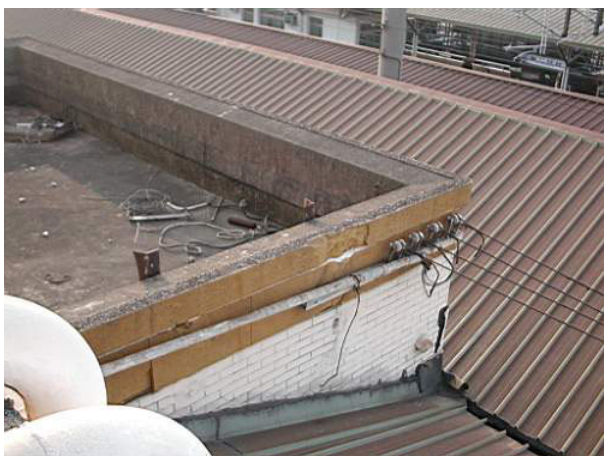
【圖 4-9-13】部分管線固定於女兒牆外側，但因為月台雨棚的遮蔽旅客不易看到
