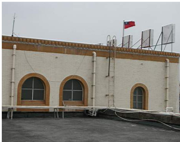
【圖 4-9-11】101R 的屋頂女兒牆上緣都配置了管線
