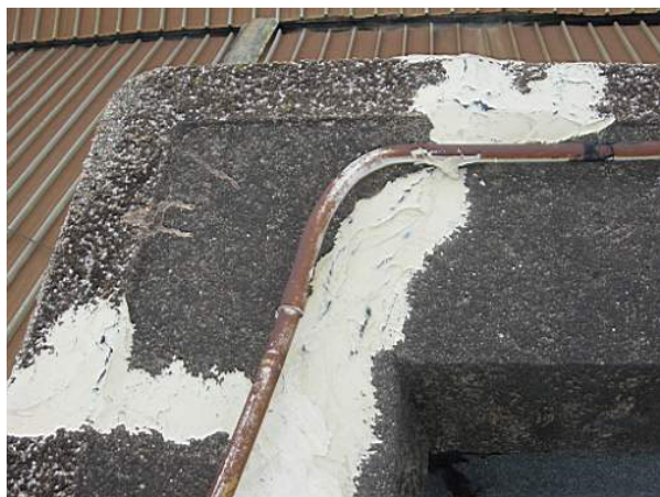
【圖 4-9-17】101R 西南側女兒牆開裂和修補
