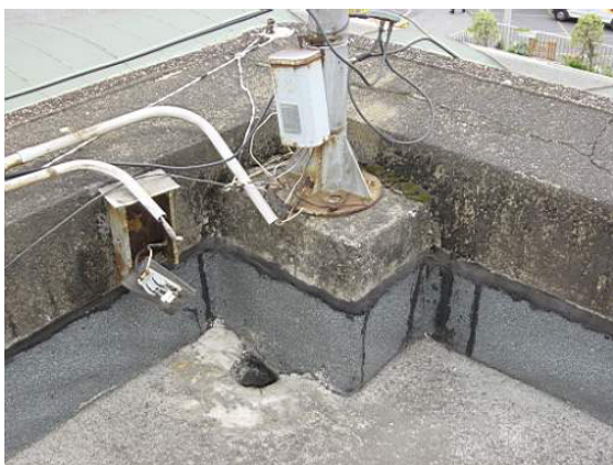
【圖 4-9-7】103R 屋頂與女兒牆的人為破壞
