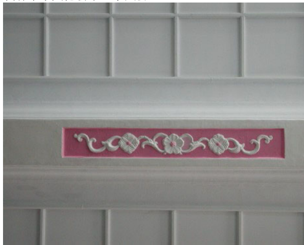
【圖 4-3-3】101R 鋼骨鋼筋混凝土梁底面紋樣現況
