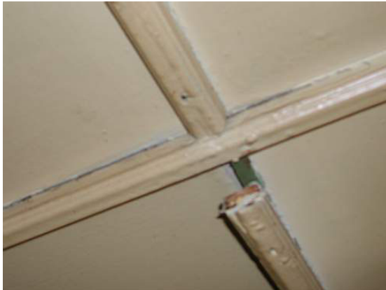
【圖 4-8-26】102R 舊有天花木作桁條脫落
