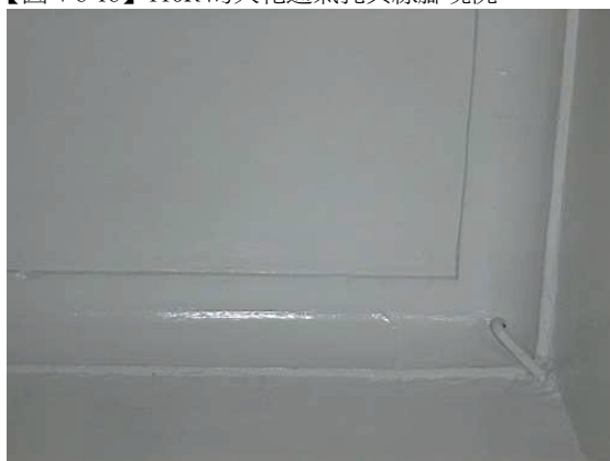
【圖 4-8-20】111R 天花線腳有管線貫穿的破壞
