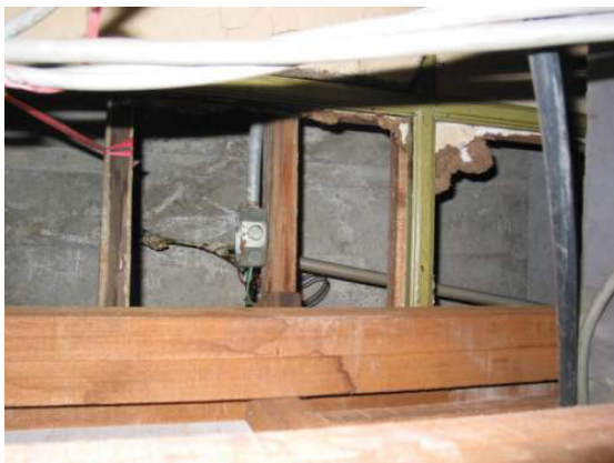
【圖 4-8-30】107R 舊有天花破損，只看到木作桁條和上方樓版的現況
