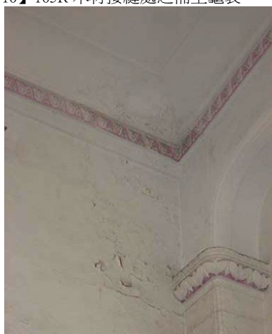
【圖 4-8-12】105R 柱編號 48 附近的天花，在角落處有漏水的痕跡
