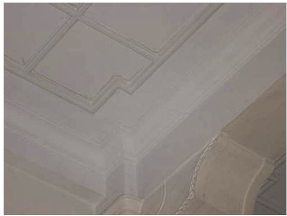
【圖 4-8-8】101R 介於柱編號 3 和 30 間鋼骨鋼筋混凝土梁的線腳有裂縫破損
