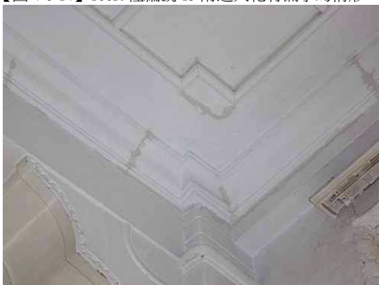
【圖 4-8-16】106R 有漏水的情形
