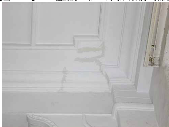
【圖 4-8-17】106R 有漏水的情形
