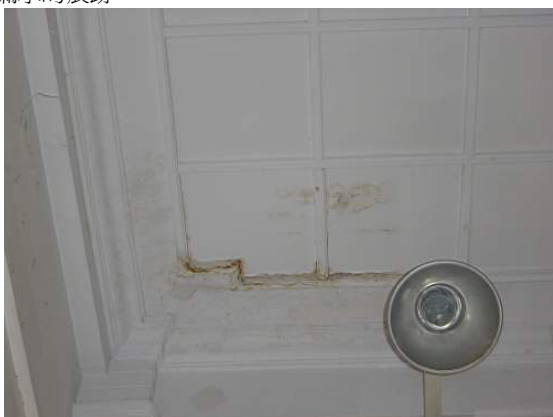
【圖 4-8-14】106R 柱編號 13 附近天花有漏水的情形
