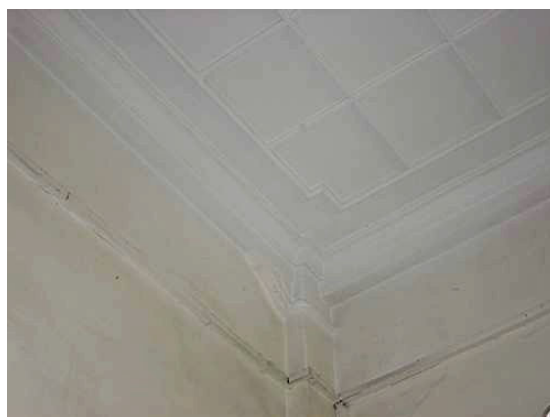
【圖 4-8-13】106R 線腳有施工不良的情形
