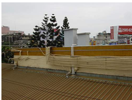
【圖 4-12-4】西向女兒牆外側有許多管線
