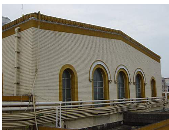
【圖 4-12-5】西向女兒牆外側有許多管線
