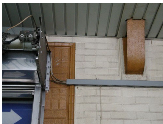
【圖 4-12-39】106-D2 的鐵捲門以螺栓固定於外牆立面的面磚
