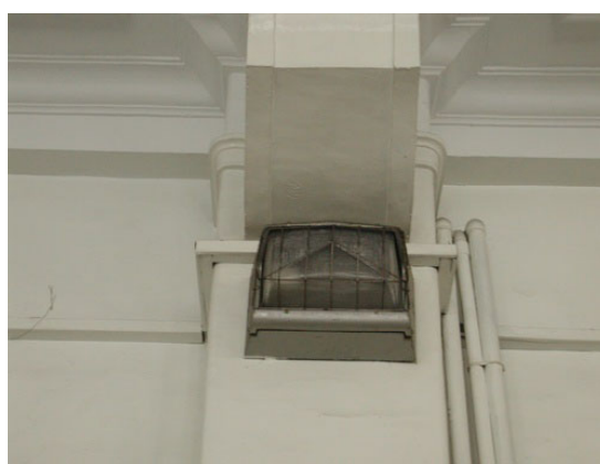
【圖 4-12-11】目前 101R、105R、106R 主要的照明設備
