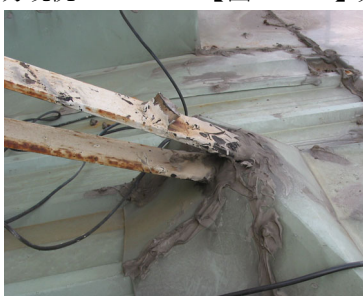
【圖 4-11-20】嘉義火車站玄關土底上方之「煉鐵製鈎金物」與屋面搭接現況。
