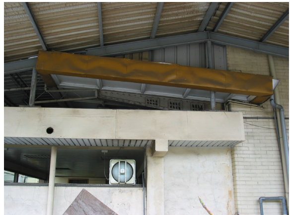
【圖 4-11-23】嘉義火車站一二等候車室前側之土底裏面現況。
