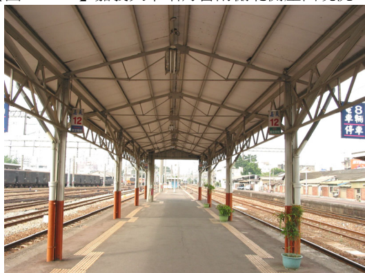
【圖 4-11-48】嘉義火車站第二月北側短向框架現況。
