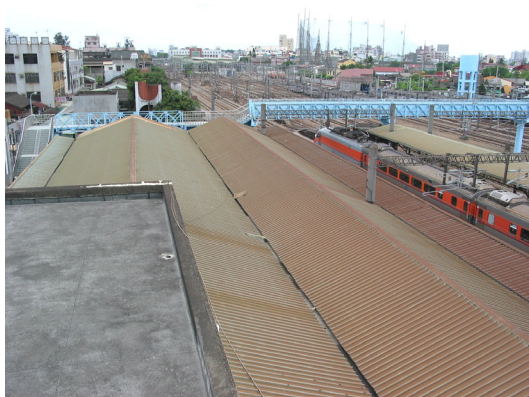
【圖 4-11-45】嘉義火車站月台雨棚南側屋面現況。
