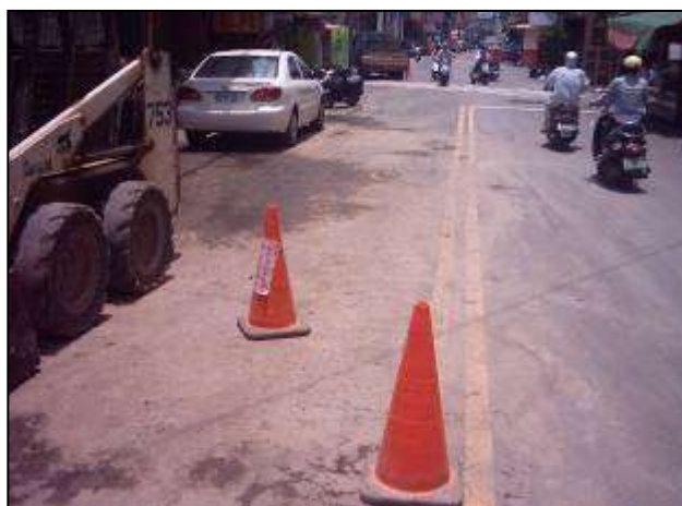
現場路面污染
