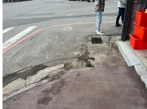
人行道破損導致通行障礙
