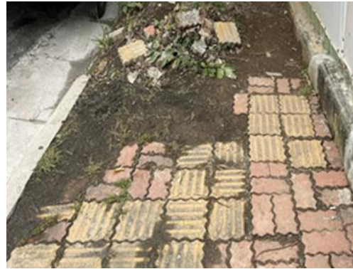
鋪面破損與龜裂
