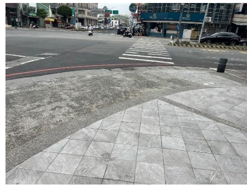
人行道銜接行穿線處欠缺導盲設施
