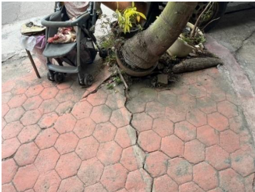
樹根隆起導致鋪面破損
