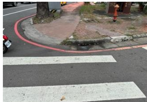
路緣斜坡未接順道路鋪面
