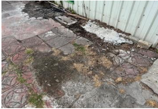
鋪面破損與龜裂
