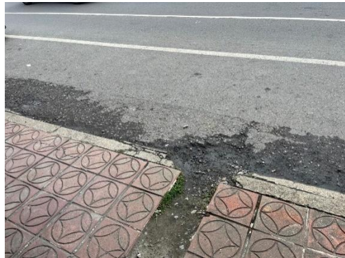
管線挖掘後鋪面未能復舊
