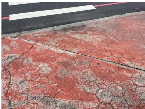
人行道銜接行穿線處欠缺導盲設施
