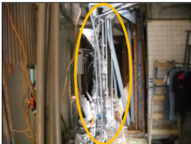
裸露排水管改善前參考相片
