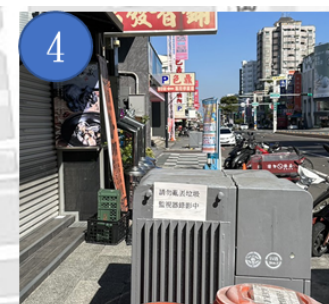
電箱阻擋通行空間
