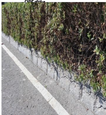
➤ 道路緣石鋼筋裸露
