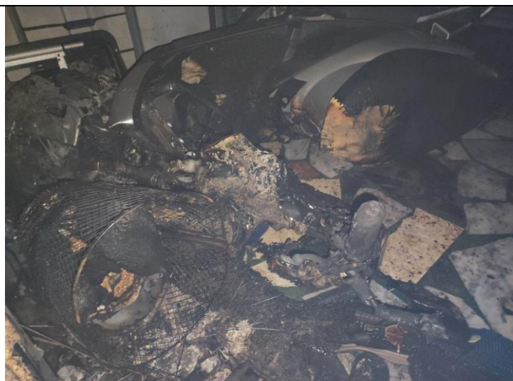
起火戶1樓燒毀情況
