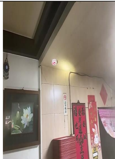
住宅用警報器動作情形(廚房)
