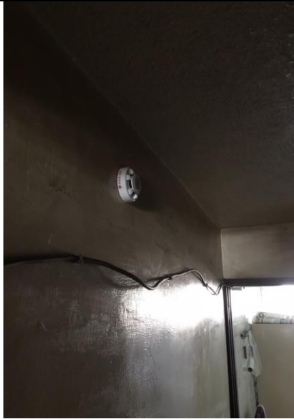
住宅用警報器動作情形(走道)
