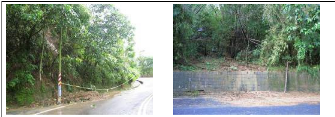
圖 6-8 環潭路週邊小規模淺層崩塌及土砂流出
