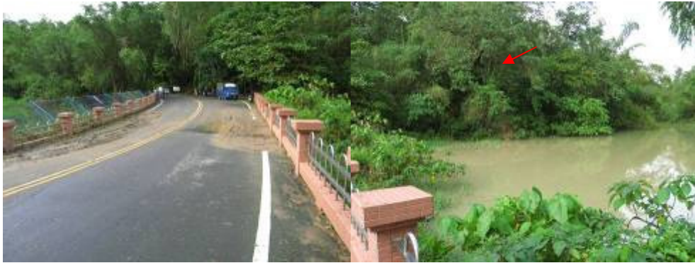
圖 6-7 蘭潭週邊二漢坡登山步道路口前河岸崩塌(箭頭處)
