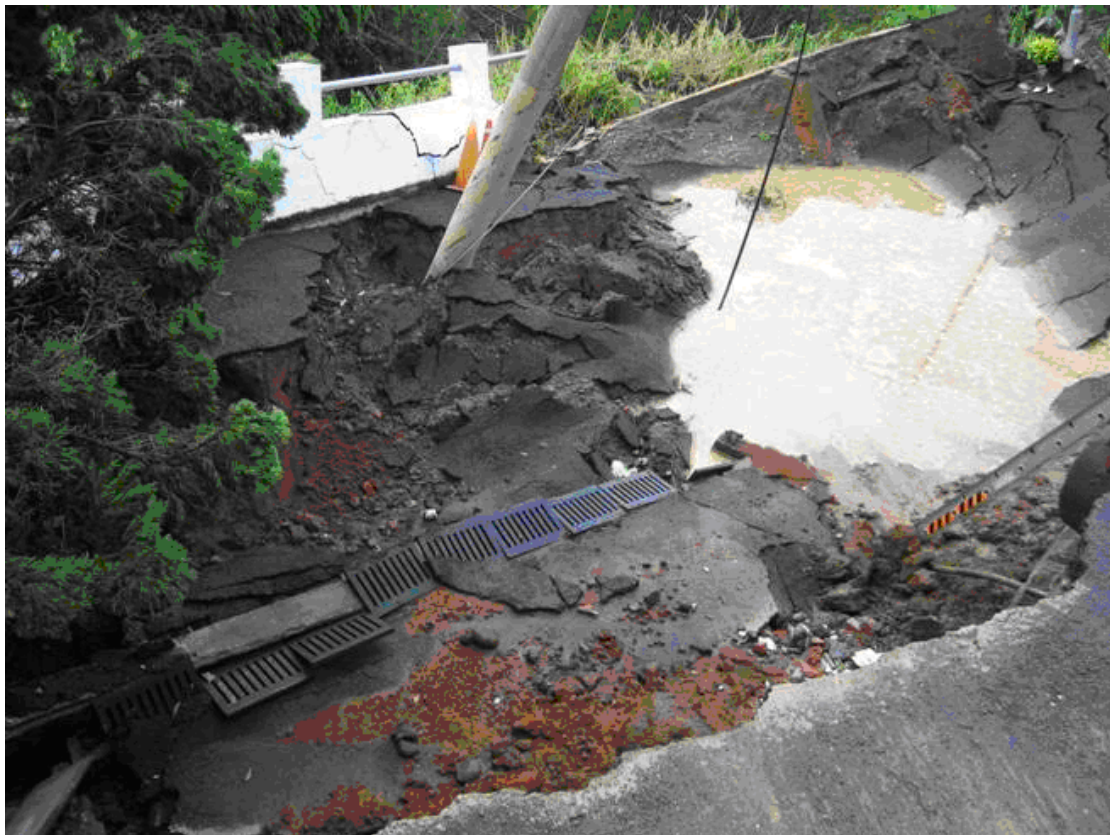
圖 6- 5 大雅路二段 386 巷擋土牆塌陷(2009/08/12 莫拉克颱風後照)
