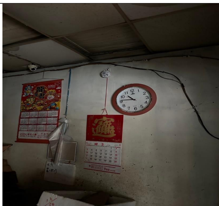
一樓住警器(有安裝未作動)
