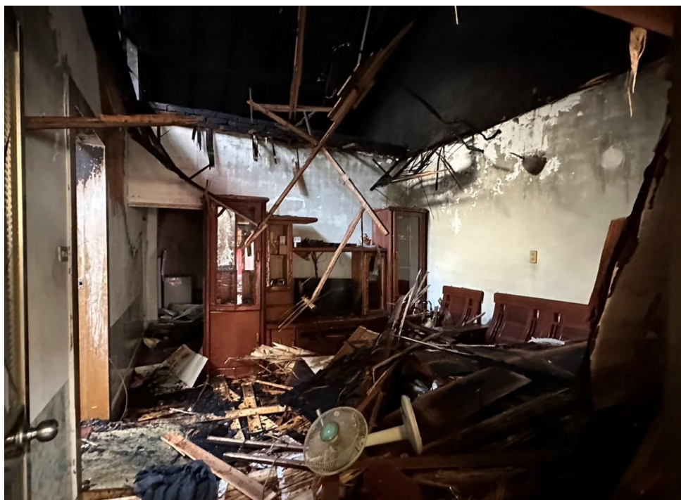
照片1：房屋受燒情形
