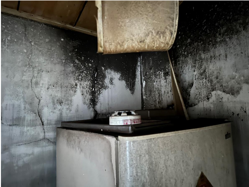
照片2：住警器裝設位置及鳴動作響情形(廚房浴廁所間廊道天花板，受燒後掉落)
