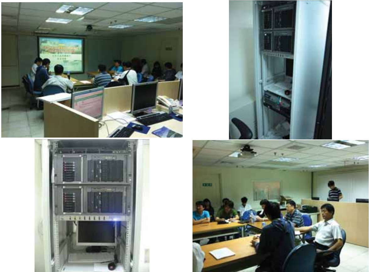
圖 2.2.1-2 交控中心內部照片
