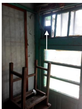
門窗玻璃破裂
