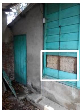
雨淋板佚失、牆面外露
