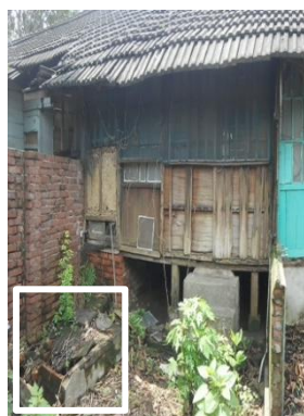
化糞池結構龜裂、落葉堆積、積水嚴重
