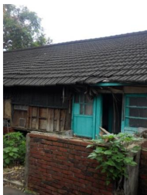
屋瓦局部傾斜佚失
