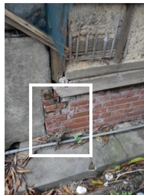
樹根危害結構、磚牆龜裂
