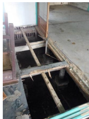
地板木構造結構體毀損
