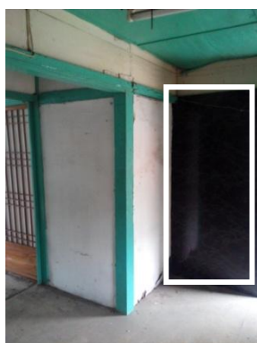
牆面後期局部以木板修補
