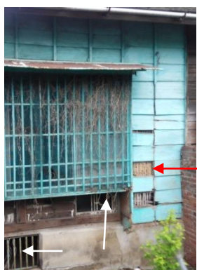
窗台下氣口窗毀損破裂、雨淋板佚失、通氣口鐵欄鏽蝕
