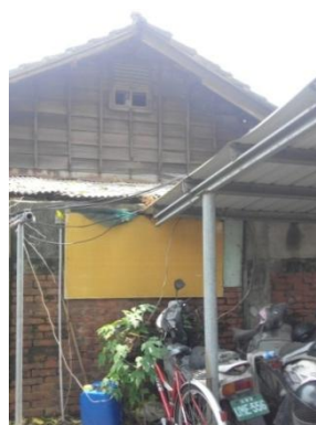
外觀圍牆增建遮雨棚、氣口窗玻璃佚失
