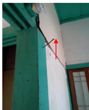
牆面後期局部以木板修補
