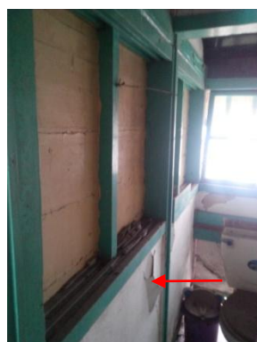
廁所牆面破損
