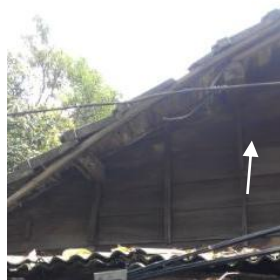
出簷板及木架構受潮腐壞
