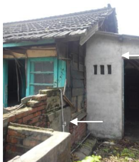
後期增建造成原建物破壞、後期增建水泥牆面龜裂
