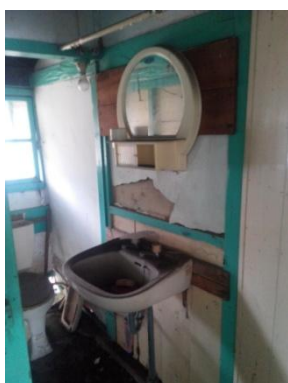
廁所牆面局部修補處損毀
