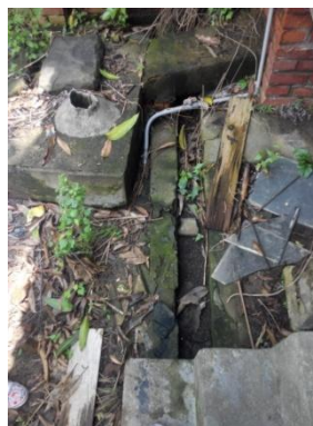
犬走及水溝局部損毀
