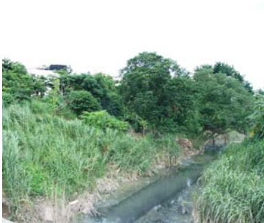
圖 4-22 後庄排水邊坡
