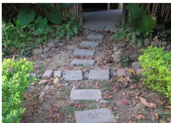
圖 8-5 入口鬆動的路基
