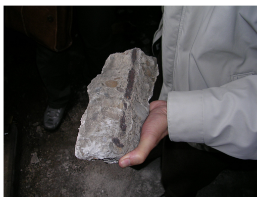
【照片 4-1-2】水錶室剝落之混凝土塊
