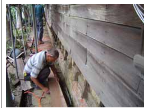
相 4-58 雨淋板腐朽破損處清理 94.9.18
