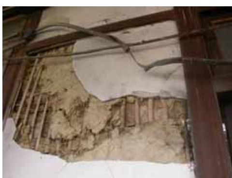
相 4-50 辦公室損壞之編竹夾泥牆 95.1.11
